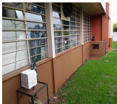
Figura 23 – Instalação de caixa no colégio
