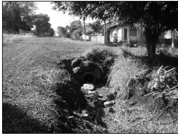
Figura 4 – Feição erosiva nas laterais da Rua Colombo. Acervo Pessoal
