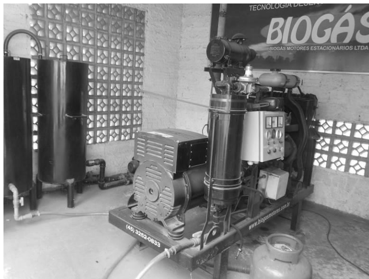
FIGURA 4. EQUIPAMENTO PARA A GERAÇÃO ENERGIA ATRAVÉS DE BIOGÁS NO ATERRO SANITÁRIO DE TOLEDO (PR).
